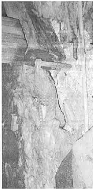
Manglende tykkelse på isoleringslag i tagrum
