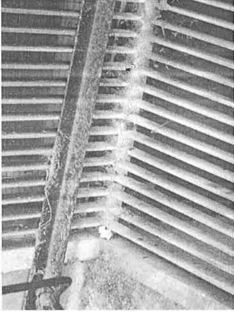
Lyskasserist fastholdt af cykelstativ
