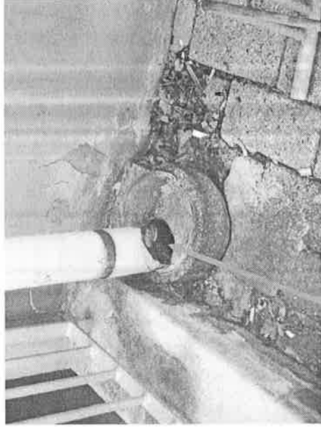
Tagnedløb med defekt
