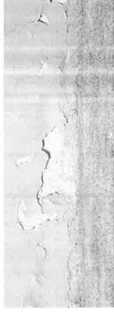
Afskallinger og krakeleringer i sokkelmaling - høvesiden
