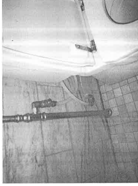
Isolerede udført med "grisehale"
